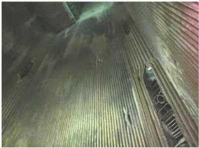
ボイラ本体映像（火炉内部）
