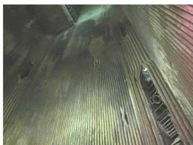
ボイラ本体映像（火炉内部）
