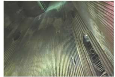
ボイラ本体映像（火炉内部）
